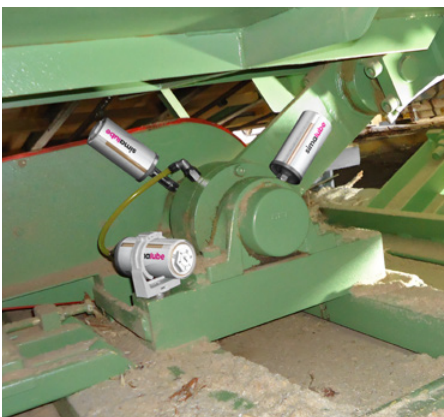
Die Lager einer Vibrorinne werden von drei Schmierstoffgebern kontinuierlich mit Schmierstoff versorgt.
