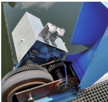
Lagerschmierung mittels Schläuchen an einem Nachklärbeckenräumer.
