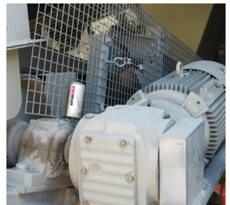
Das Stehlager eines Förderbandes wird kontinuierlich mit einem simalube geschmiert.
