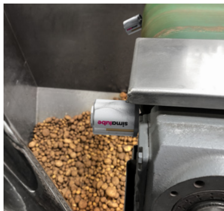
Deux simalube de 60ml lubrifient les roulements de la poulie de renvoi d'un tapis roulant dans la transformation des pommes de terre.
