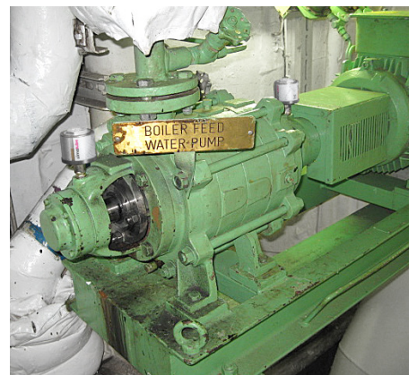
simalube de 30 ml están instalados sobre la bomba de agua de la caldera de vapor.
